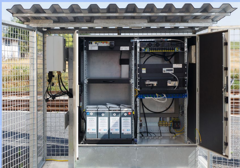
Technická skříň s Radio Remote Head modulem ve stanici Třebenice
